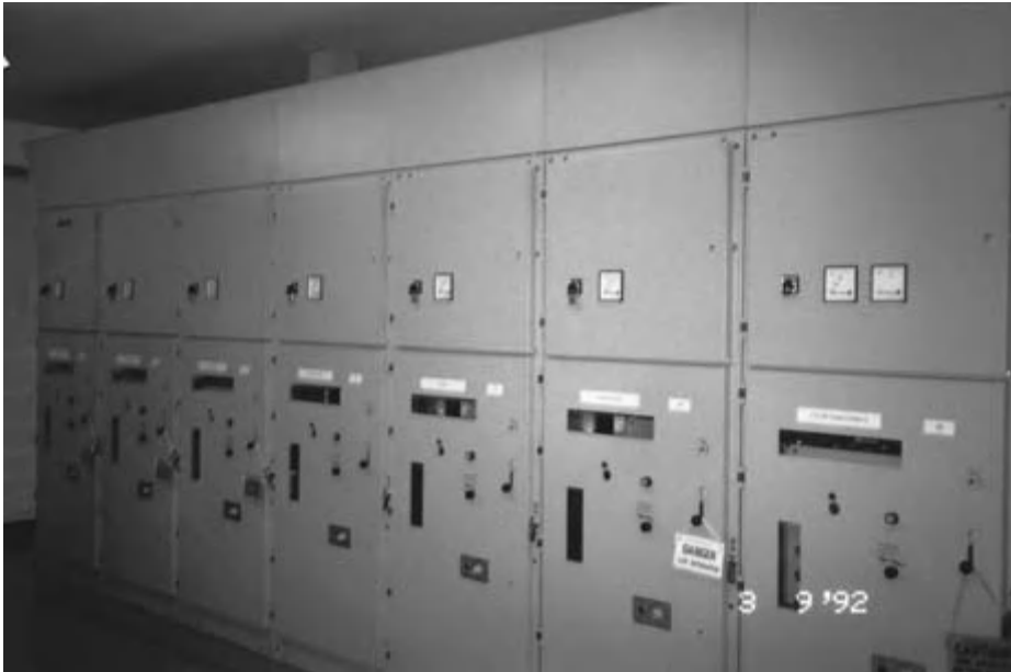
Fig. 2.1 11kV switchboard, Jersey ( Siemens plc ).
